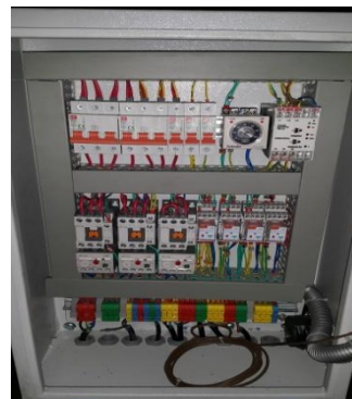
نمای داخل تابلو برق
